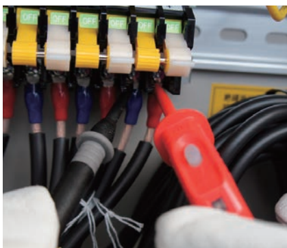
无需遮光在汇流箱即可进行检查
